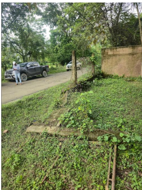
Cerco de malla ciclón, el cual se cayó debido a su antigüedad y falta de mantenimiento.
